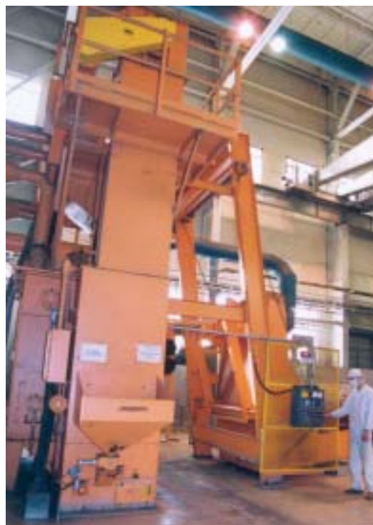
Рис. 1. Установка дробеструйной дезактивации
